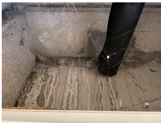
Billede 4. Tegn på vandindtrængning mellem facade og etagedæk.
