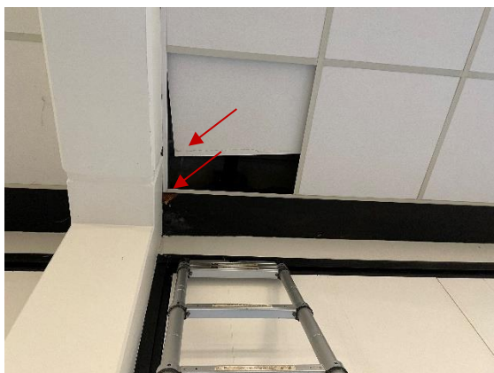
Billede 3. Fugtskjolder på loftplader.
