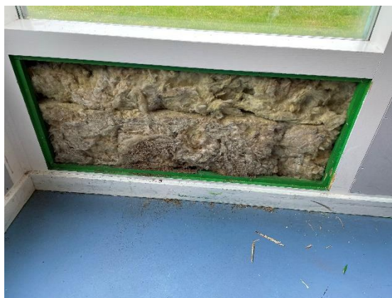
Billede 7, viser område ved tidligere vandskade med brystningsplade afmonteret, ved skimmelpøve P3.
