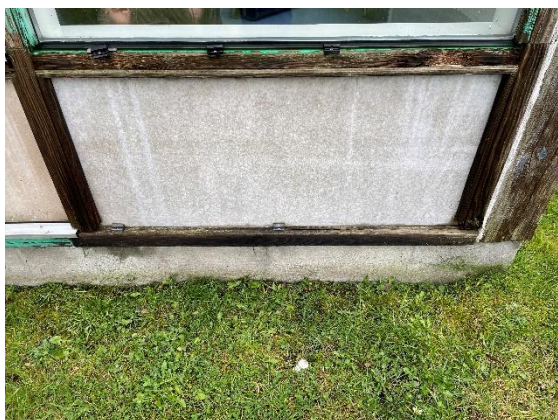
Billede 6, viser udvendig side let facade ved tidligere vandskade.
